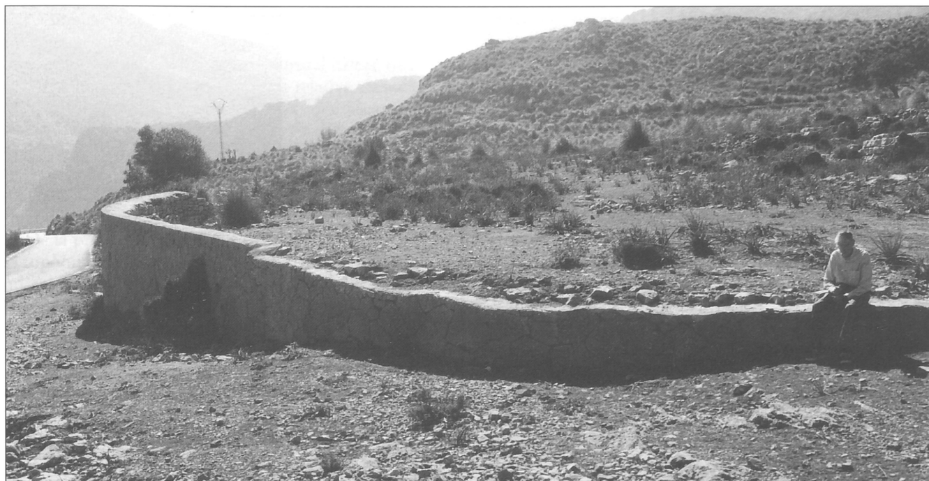
Detall de la paret de contenció vista des de la part superior.
