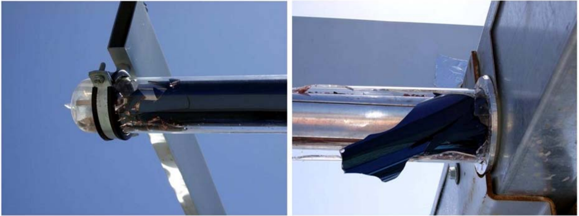
Figura 7.37: Rotura de tubos receptores
