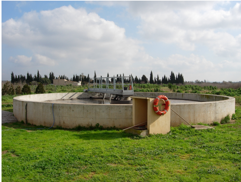
Figura 3.7. Tanc de decantació del tractament secundari de l'estació depuradora d'aigües residuals de Santa Maria que funciona mitjançant el sistema de fangs activats.
