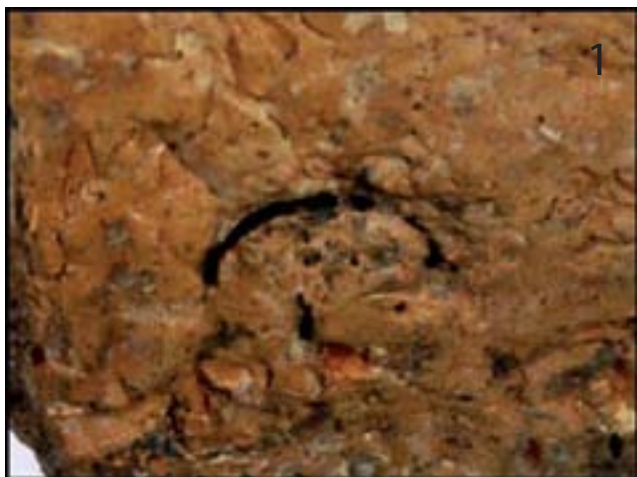
Grieta semicircular que indica la inserción del extremo del asa de cinta
