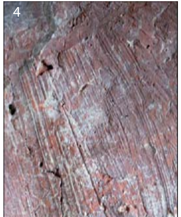
Acanaladuras rayadas formadas durante el compactado
