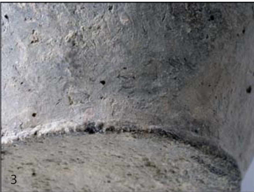
Rebabas que evidencian el alisado y arrastrado de la base
