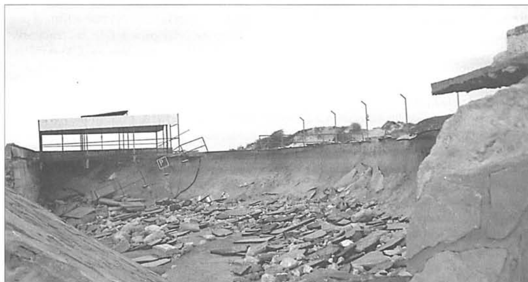
Figura 3. Colapso de un aparcamiento costero debido a procesos de erosión cerca de Punta Candor.
