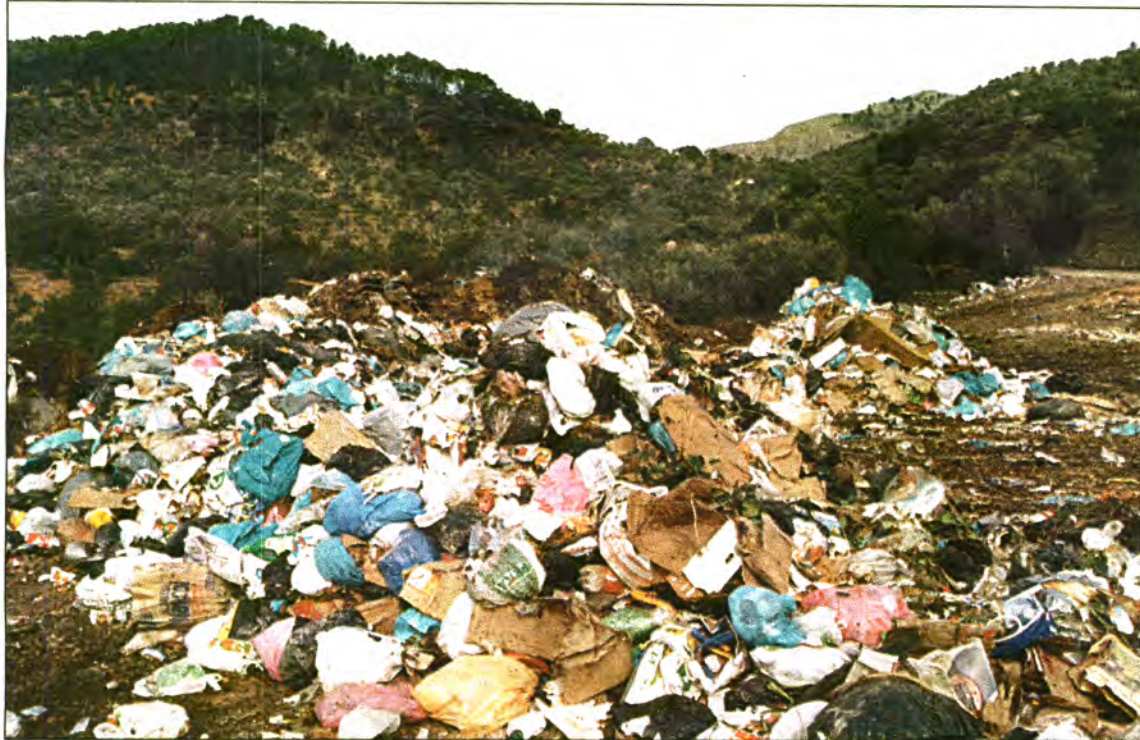
Les màquines excavadores preparen el terreny per tancar parcialment el fems acumulat durant molts anys al camí de sa Figuera.
