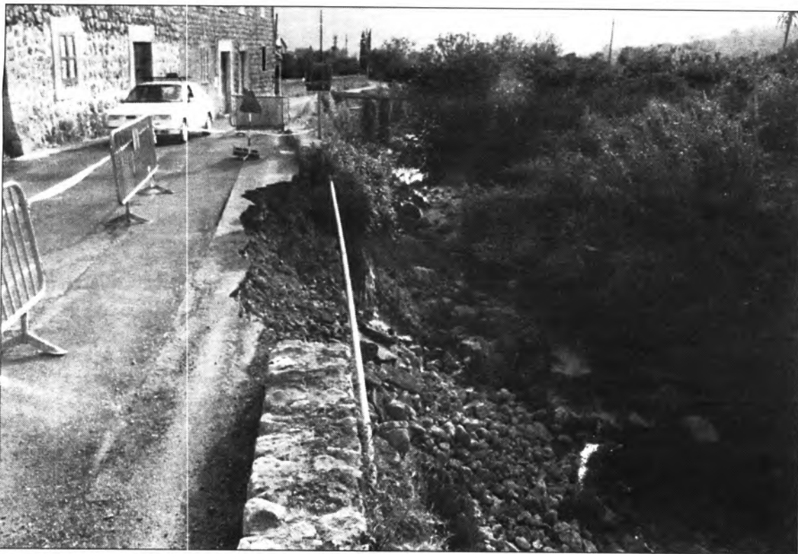
El mur de pedra feia temps que ja tenia panxa i amenaçava de desprendre's.
