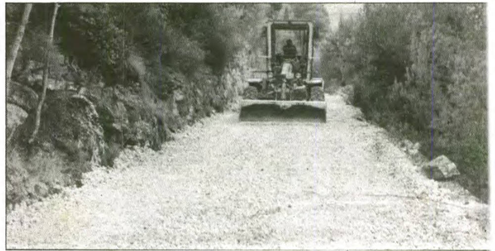
Abans d'asfaltar s'han aplicat dues capes de material granulat de diferent gruixa.
