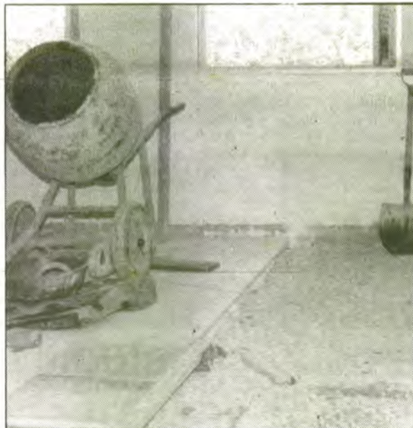
L'empresa constructora ha comprovat que els fonaments no són suficients per aguantar el pes de més pisos mitjançant diferents forats al sòl.
