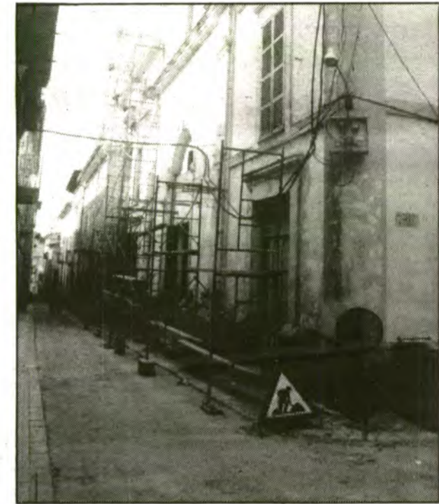
Les obres de restauració de la façana han obtingut una ajuda del Pla de Millora de Façanes. Ara manca repassar la teulada.
