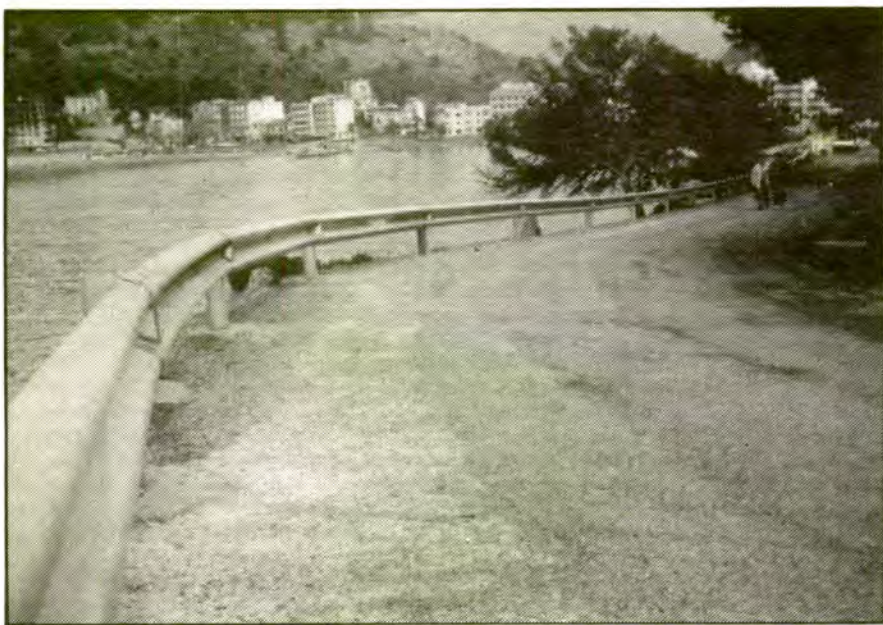
La manca de protecció de la cuneta lateral del camí del Far ha donat lloc a alguns accidents.
