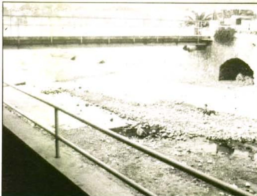
Els ferros que sustenten el pontet estan oxidats. Per reforçar-lo, s'haurà de redactar un projecte nou.
