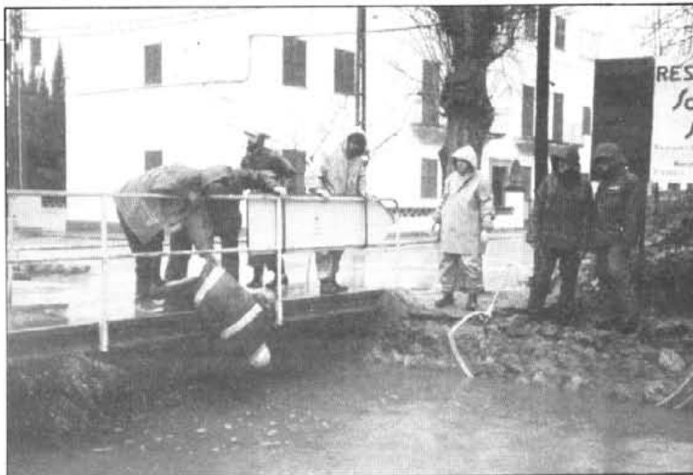
Bombers i municipals hagueren de desembossar el pont del Torrent de Sa Figuera.
