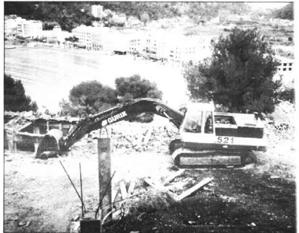
Les Normes que ha dictat la Conselleria no influeixen per res en les obres que es fan a sòl urbà.
