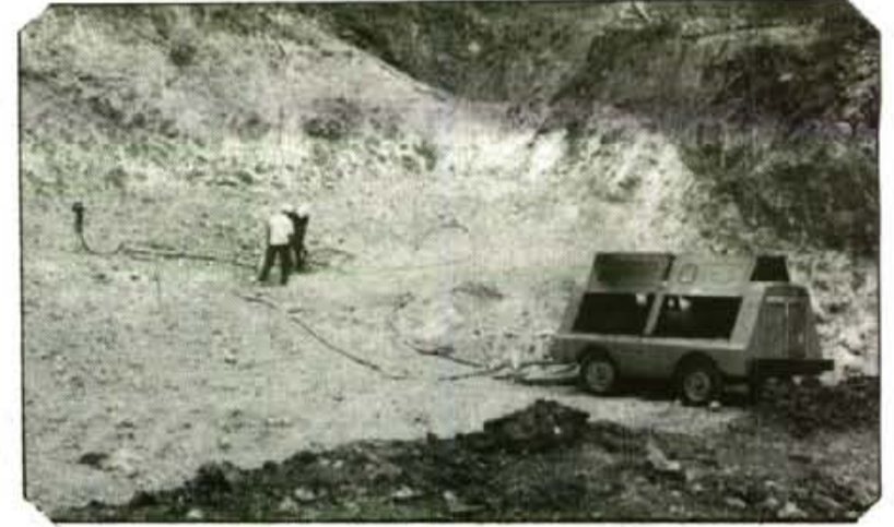
Es comença a fer el fonçal per a la futura entrada del túnel a la banda d'Alfàbia. Just a un metre de fondària ja és tot roca.
