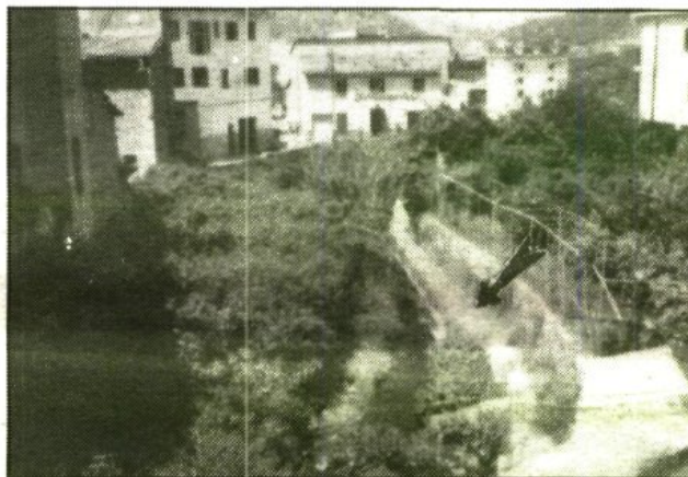
La fletxa mostra la canalització general. El gorg ha sotsavat els fonaments, i la vegetació cobreix el llit del Torrent Major.
