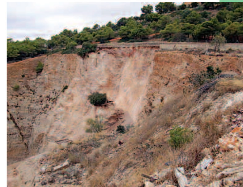
El consistori va decretar el tancament de la gravera com a mesura cautelar després del desprendiment de la carretera de Consolació
