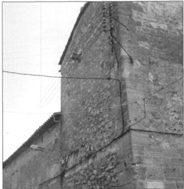
— La farola que han plantat a la Torre de Defensa no s'adequa gaire a l'edifici
