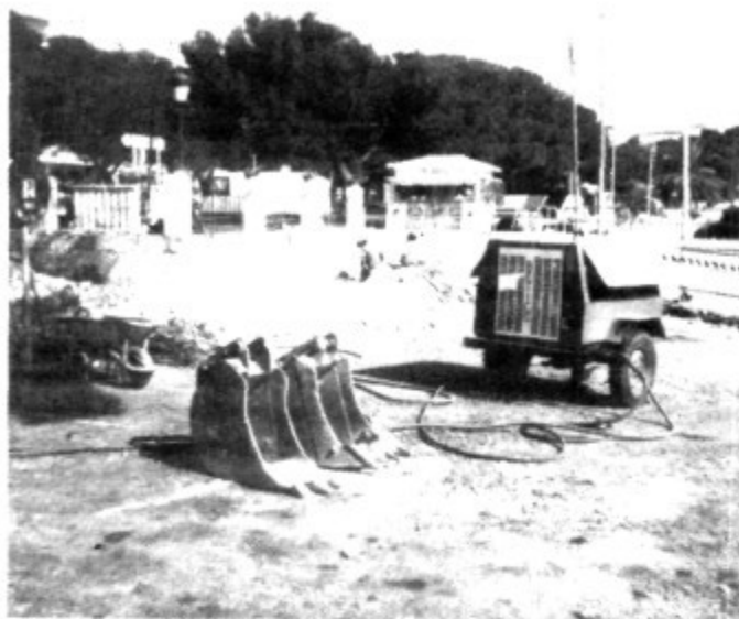
Las obras donde aparcen los autocares se acabarán muy pronto, la urgencia posibilitará el aparcamiento de los autocares.
