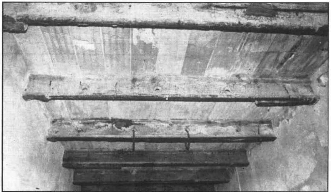
Las viguetas que sostienen las terrazas a las que todos tienen acceso, están totalmente deterioradas
