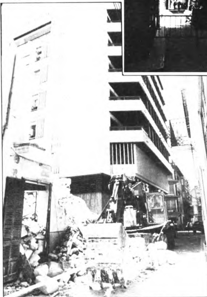
El Carrer Major y calles adyacentes quedaron colapsadas
