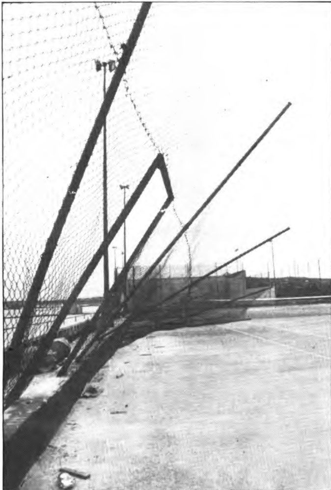
La valla metálica ha perdido su verticalidad
