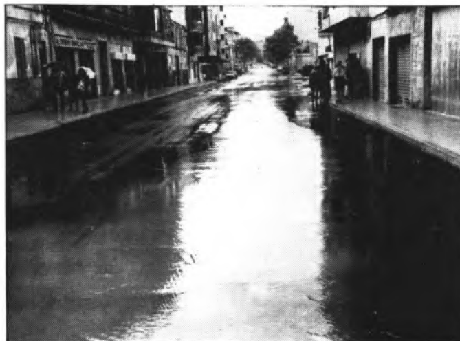
El agua caida se concentraba en el centro de la calzada, en lugar de ser orientada hacia las bocas de recogida. Unos defectos que ahora están siendo subsanados.
