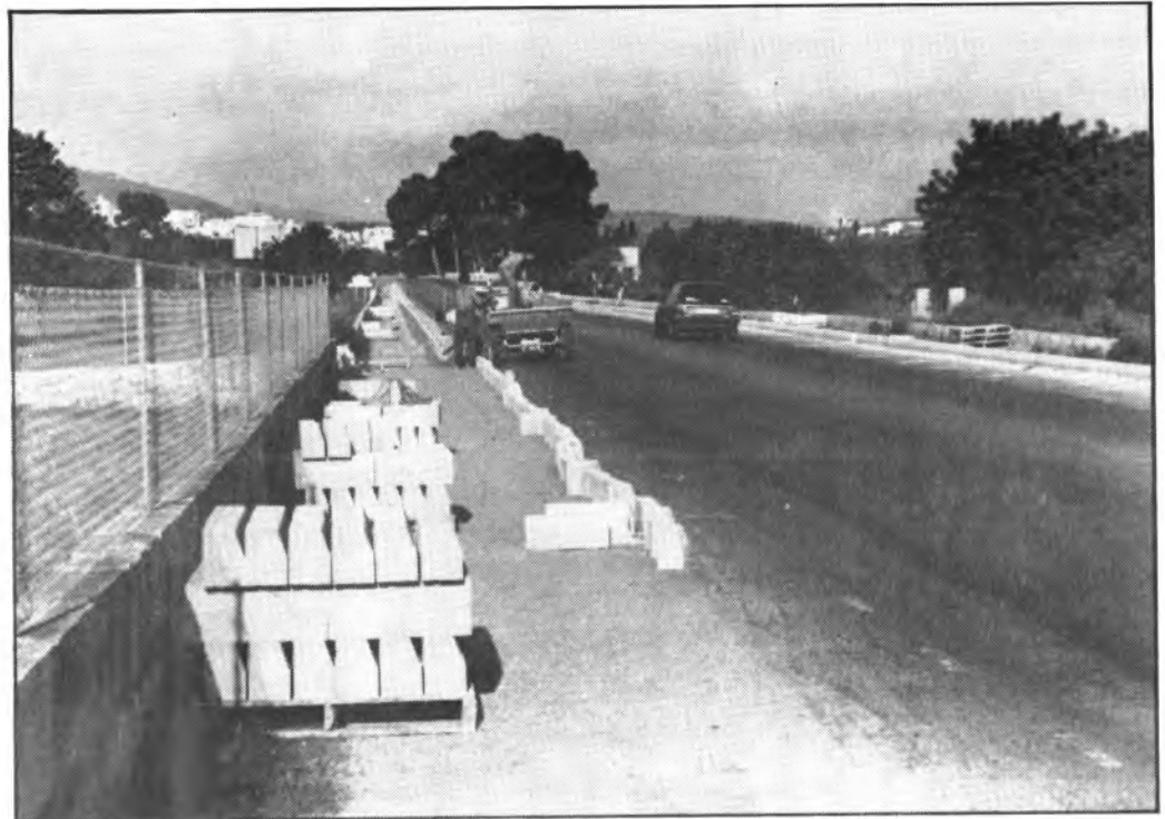
Aspecto que ofrece la carretera de Son Servera a Cala Millor con las obras de construcción de las aceras
