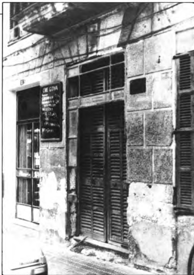
Otra degradada fachada de la avenida Salvador Juan
