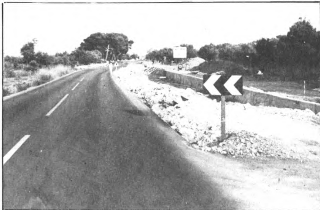
Aspecto que ofrecen las obras de ensanchamiento de la Carretera de Cala Millor a Son Servera o viceversa. Foto: Forteza Hnos.
