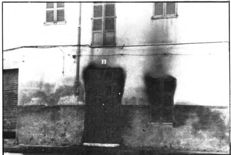
La façana de la casa que es va cremar
