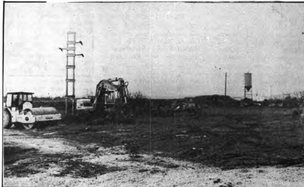
Com podeu veure les excavadores estan a punt de començar a treballar
