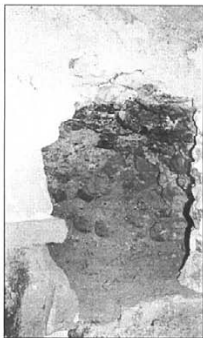
El rebost, totalment esbucat.
