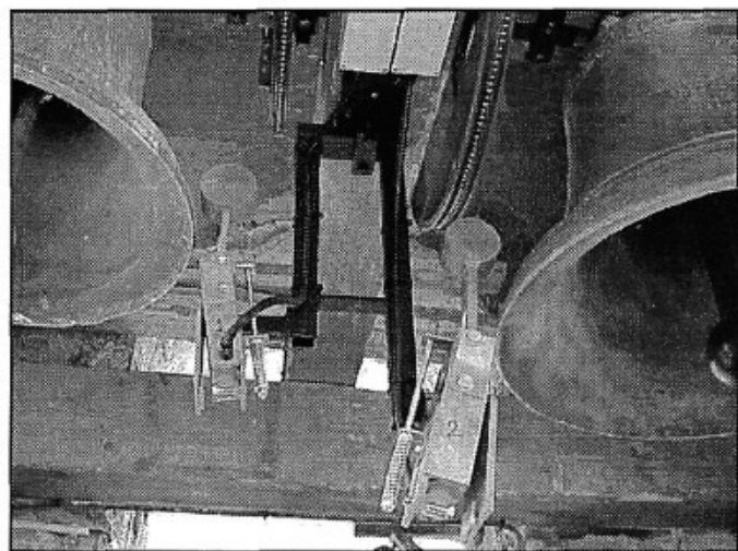
Vista dels engranatges que permeten fer sonar les campanes
