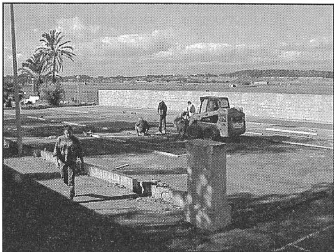
Moment de les obres a la pista de tennis. Ara ja està pràcticament llesta
