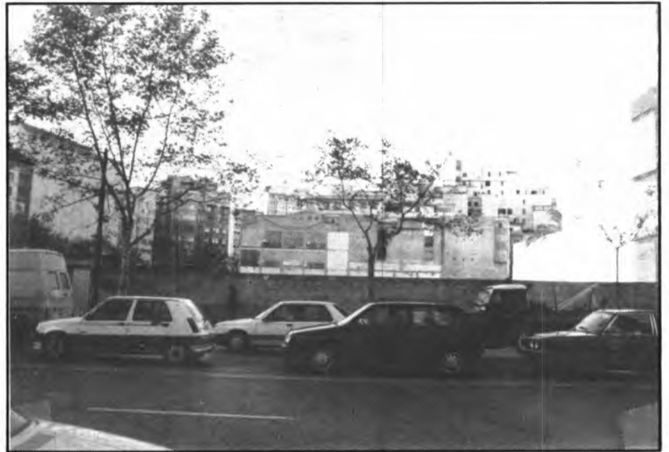
Les obres d'enderroc per a construir El Corte Inglés estan pràcticament acabades.
