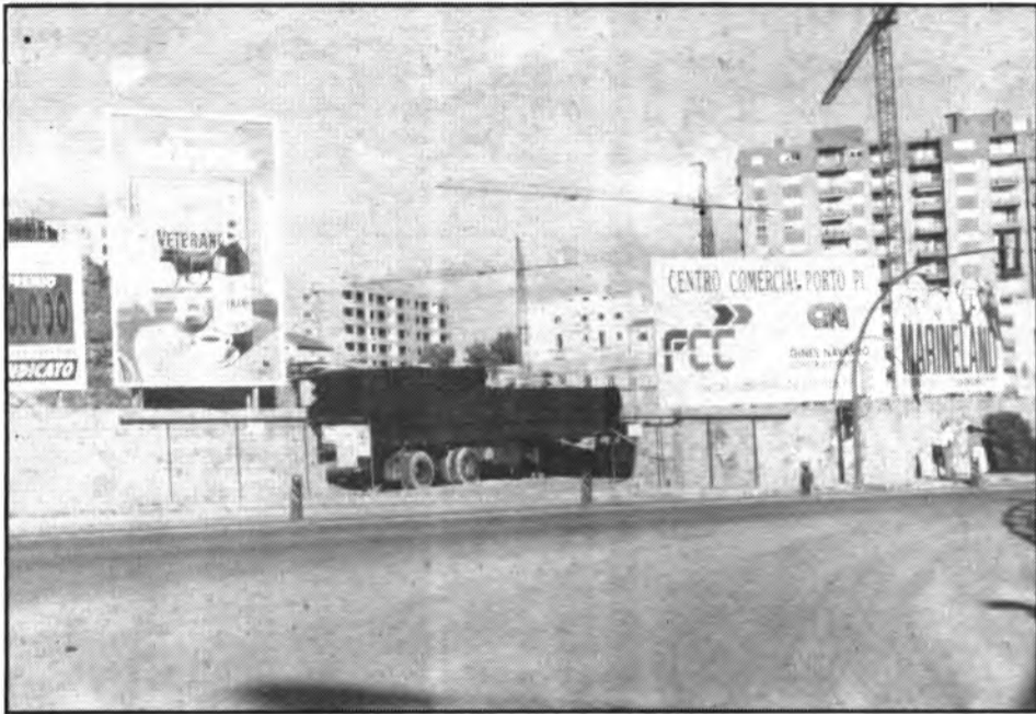
Les obres de construcció del Centro Comercial Porto Pi ja estan en marxa.
