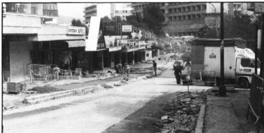
Este tramo de la calle Punta Ballena debería estar ya terminado.
