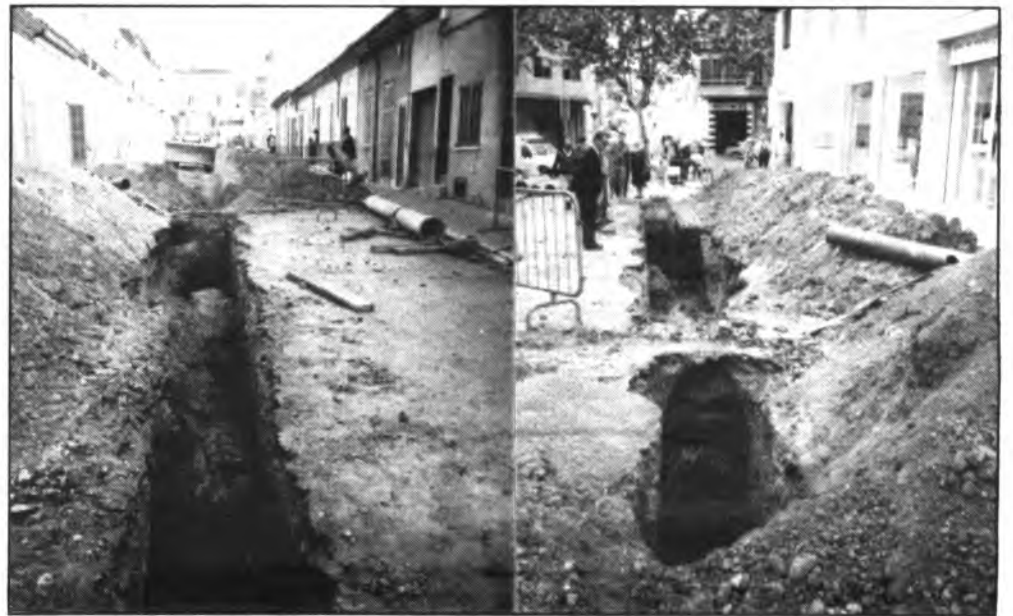
El desprendimiento de tierras, determinó la tragedia de la calle Isaac Peral. (Foto: ANDRES QUETGLAS).
