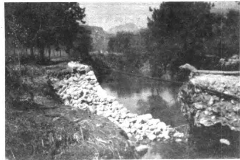
de tantos años de sufrir el azote de las aguas, se de definitivamente solución a este problema que ha causado tantos daños materiales y ha dado tantos sustos al vecindario.
