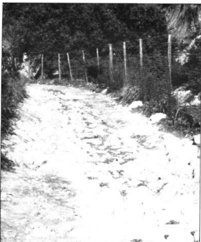
A l'enreixat encara es poden veure restes dels materials arrossegats pel torrent, que arriba a passar per damunt el Pont de Son Oliver
