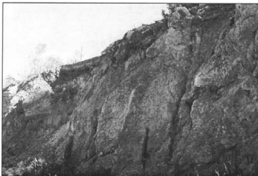
Excavació feta a l'entrada del Coll des Vidrier. A la part terrossa hi ha constants esllavissaments que a vegades arrosseguen alguna roca. A aquest indret el subsòl de la muntanya presenta crulls que és per on s'escola l'aigua que, dins el túnel, ajuda a que hi hagi desprendiments.
