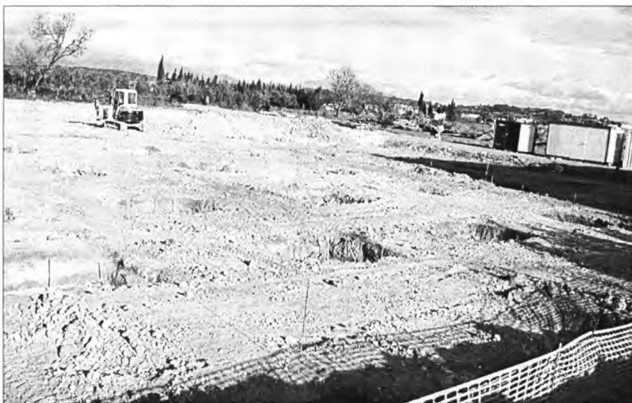
Ja han començat les obres per a la construcció de la residència de persones assistides
