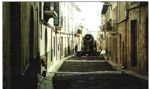
Les obres d'empedrat fan el carrer major intransitable
