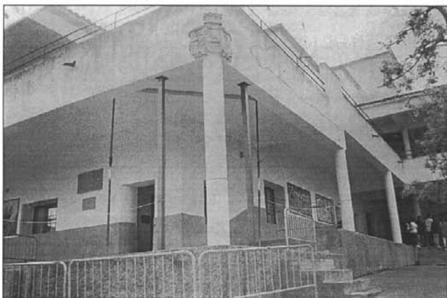
Encara continua apuntalada la columna que aguanta l'estructura de l'edifici
