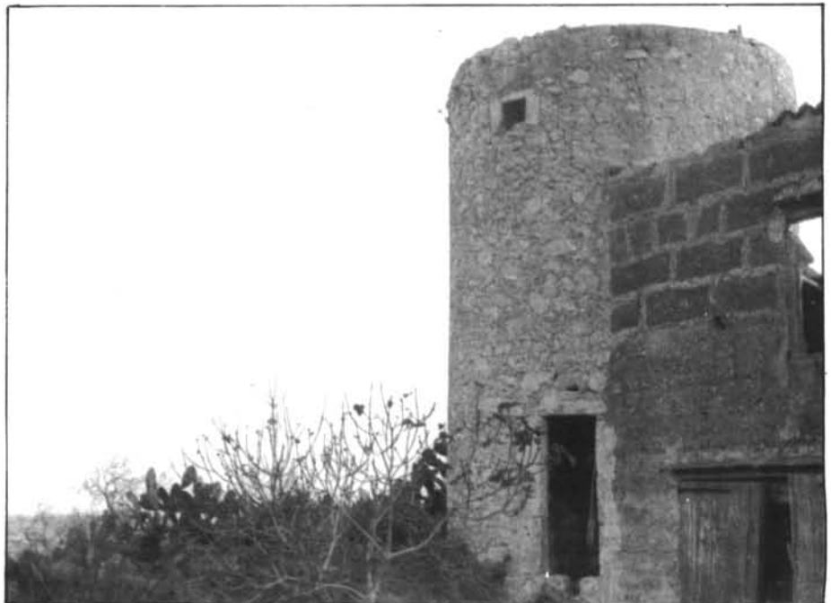
MOLINS EN MAL ESTAT
