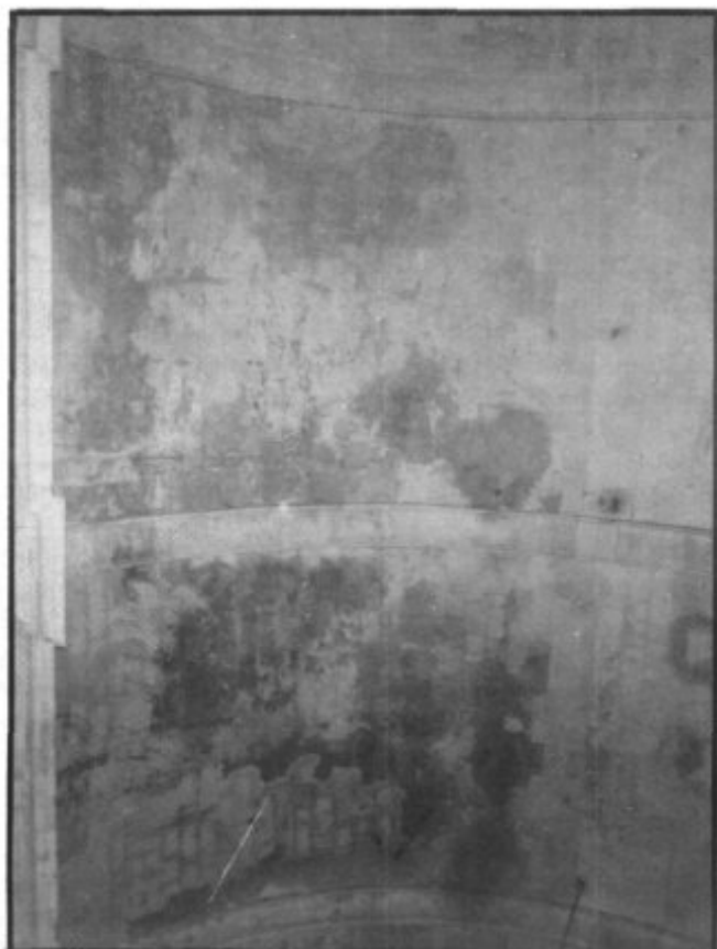
ESTE ERA EL ASPECTO QUE OFRECIA LA BOVEDA ANTES DE LA RESTAURACION, A LA DERECHA, EN LA ACTUALIDAD
