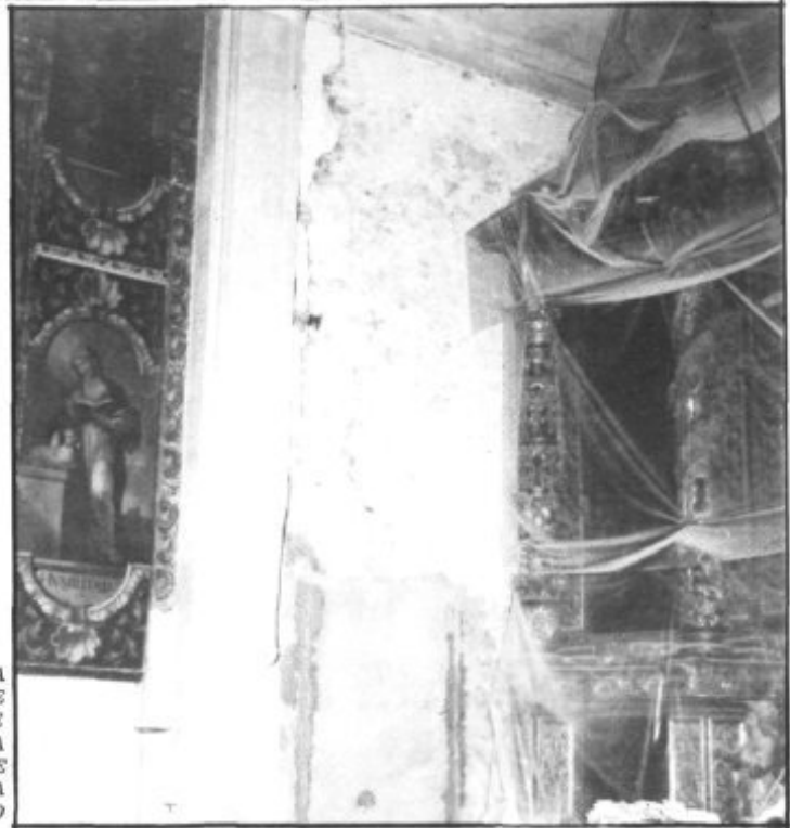
SOBRE LA PARED SE PUEDE APRECIAR LA GRIETA QUE SE HA ABIERTO
