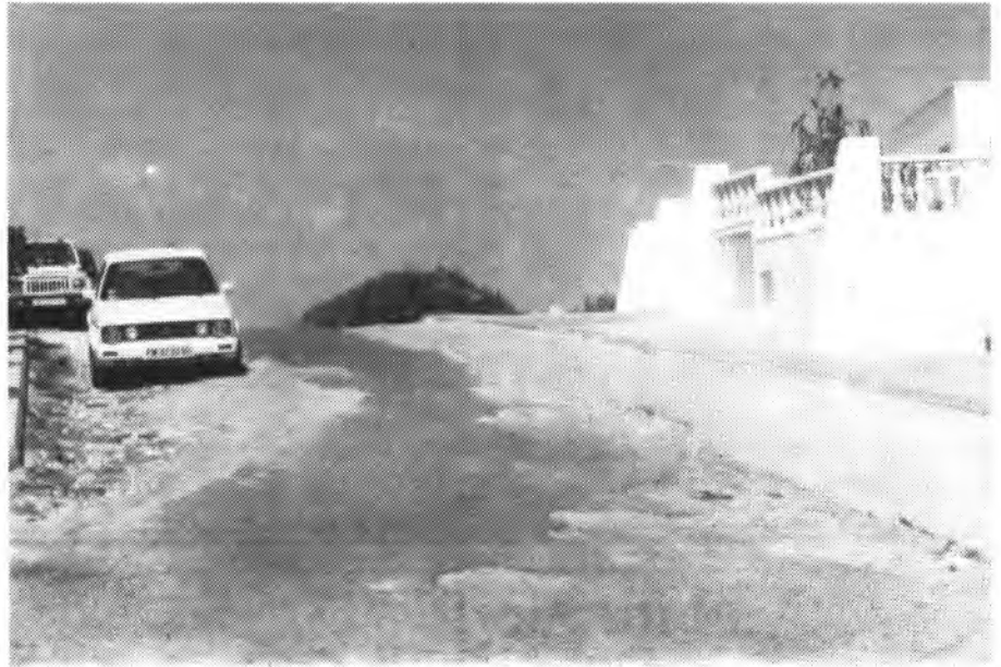
Los baches de la calle Sa Punteta no dejan paso libre para los coches
