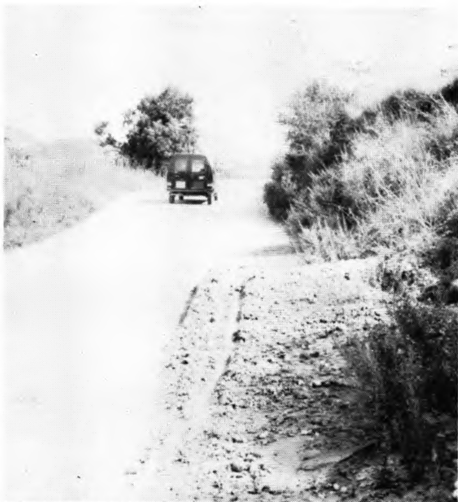
L'Ajuntament té previst sembrar la costa dels abisaments per evitar desprendiments.
