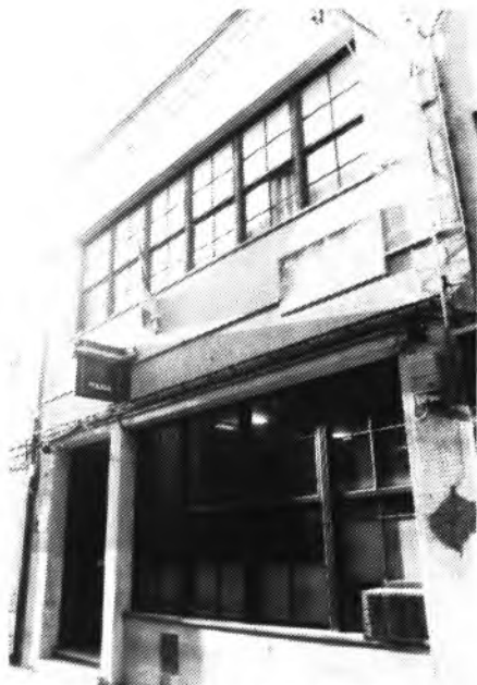
La actual Comisaría de la Policía Nacional se encuentra en muy mal estado. En algunas salas se aprecian fácilmente numerosas grietas, con el peligro de derrumbe
