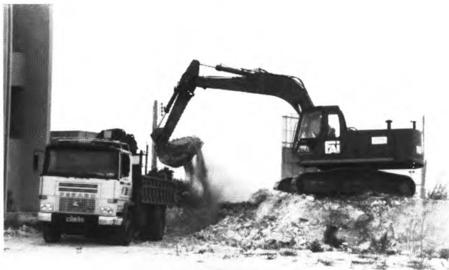
El jueves por la mañana comenzaron las obras del Hospital bajo la supervisión de los técnicos de Ferrovial.
