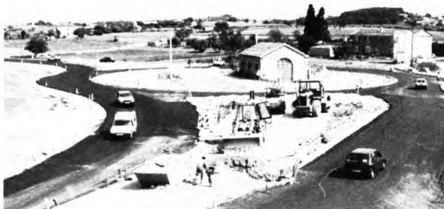
La caseta on es guarden els cilindres d'Obres Públiques ha quedat de moment ubicada al centre de la rotonda que es construeix a l'entrada de la carretera de Manacor en direcció a Porto Cristo.
