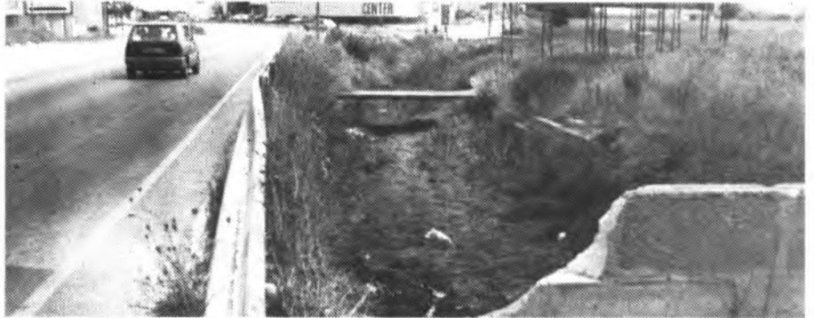
El torrent de Sa Cabana ha provocat diverses inundacions.
