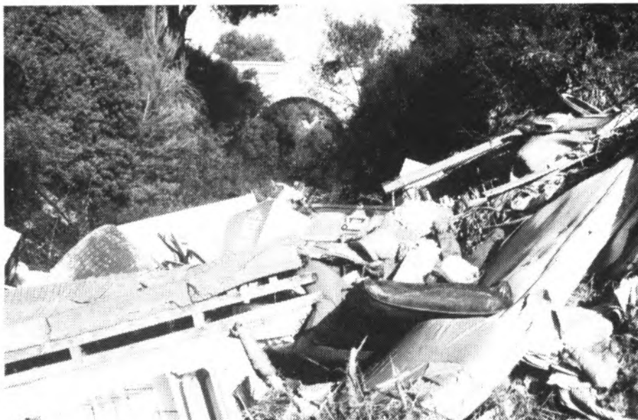
Forns, geleres i altres electrodomèstics presenten un estat molt degradable en el pont ubicat a la carretera de Manacor-Son Carrió.
