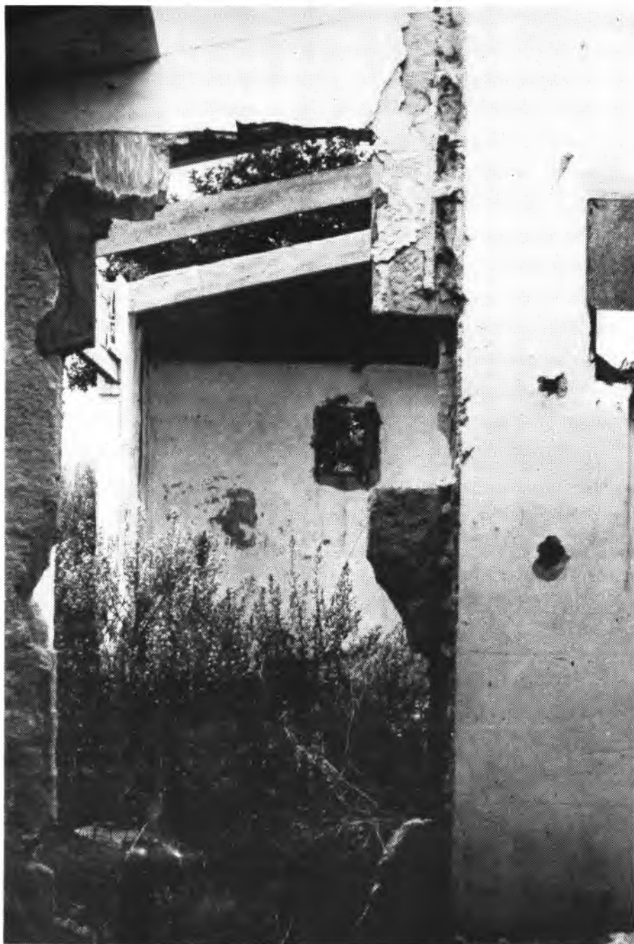
L'escola de Son Negre, probablement és la que es troba interiorment més degradada.
